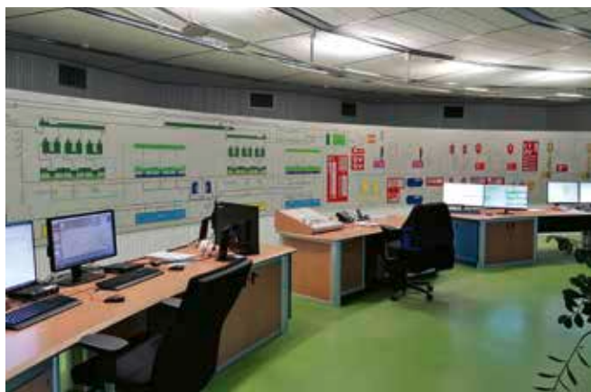
Die Schalt- und Kontrollzentrale des Max-Binder-Wasserwerks in Flanitz mit dem schematischen Ablauf der Trinkwassergewinnung von Waldwasser.
